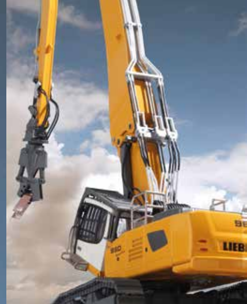
Filigrane Darstellung der Hydraulikleitungen auf dem 33 m Abbruchausleger.
